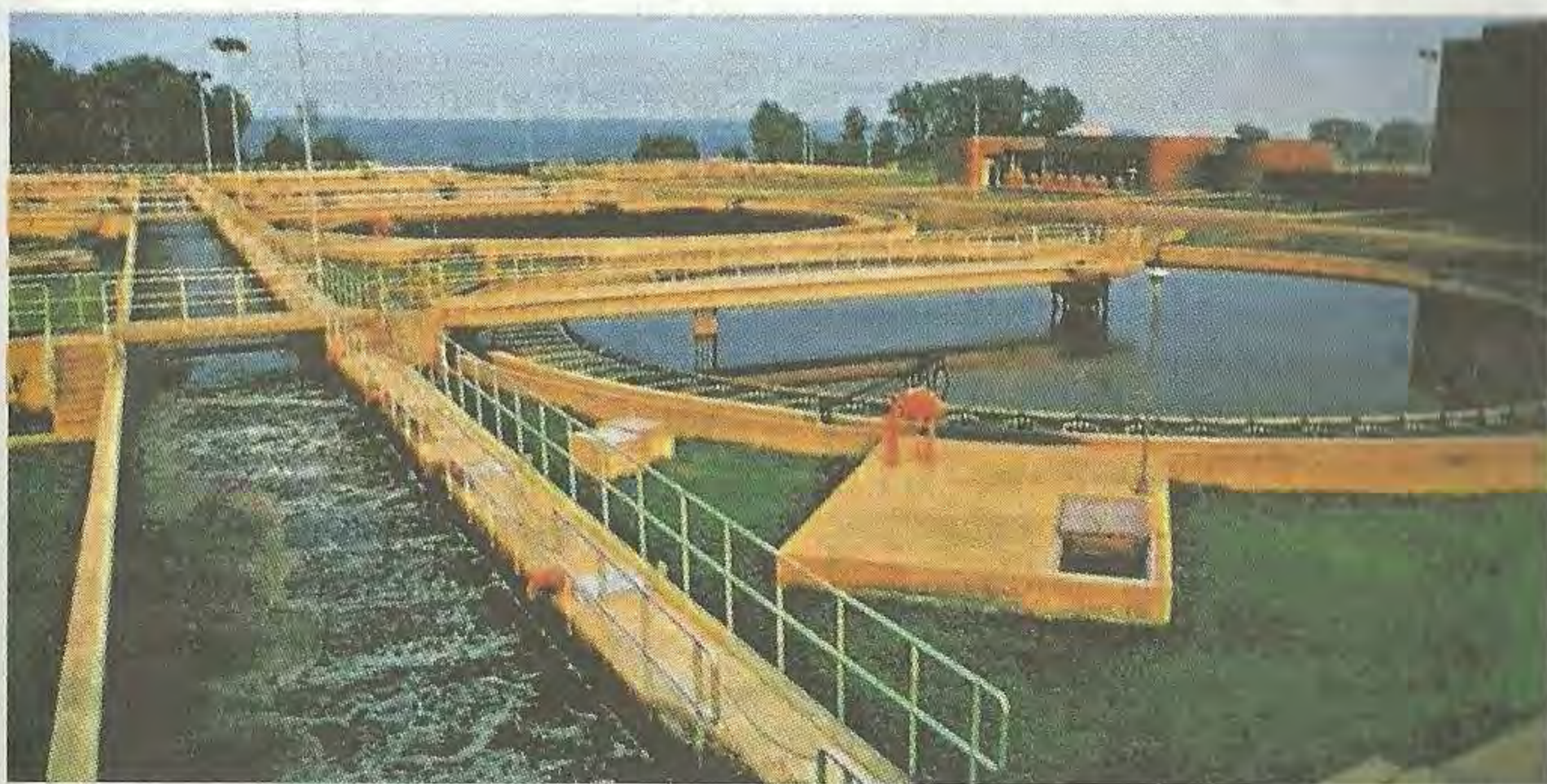
Рис. 183. Сооружения по очистке воды
